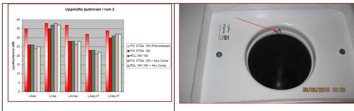
Figur 8 Ljudmätning på tilluftsdon i provlägenhet, som först gav 32dB pga. skruv som ventilationsentreprenören fixerat donet med (Markerad med röd pil). När skruven demonterades blev det 23 dB(A), som i sovrummet bredvid.
